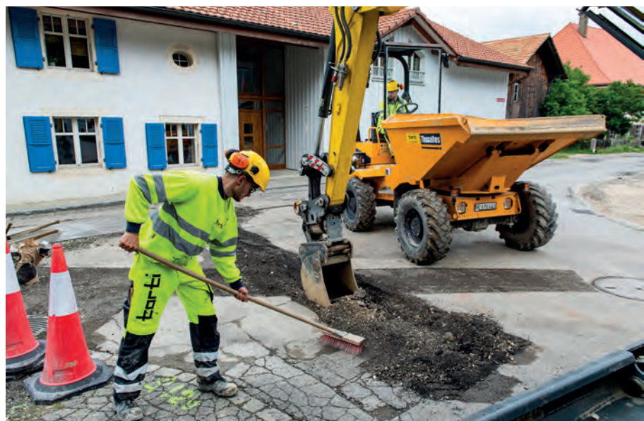
^ Anche i lavori di riparazione fanno parte della quotidianità dei costruttori e delle costruttrici stradali.
