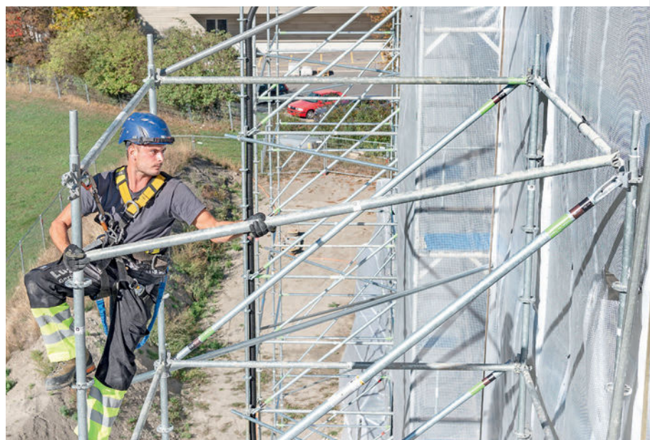
È così che si montano i ponteggi a torre, che rendono stabile l'impalcatura principale in caso di forte vento.
