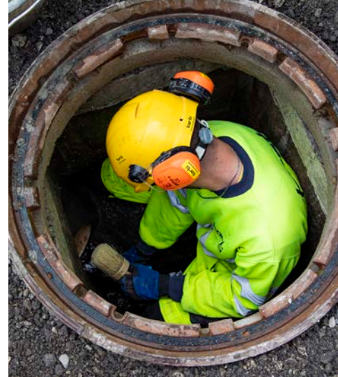
▲ Dans la chambre de visite, Eric Estevez peut vérifier l'état des conduites.
