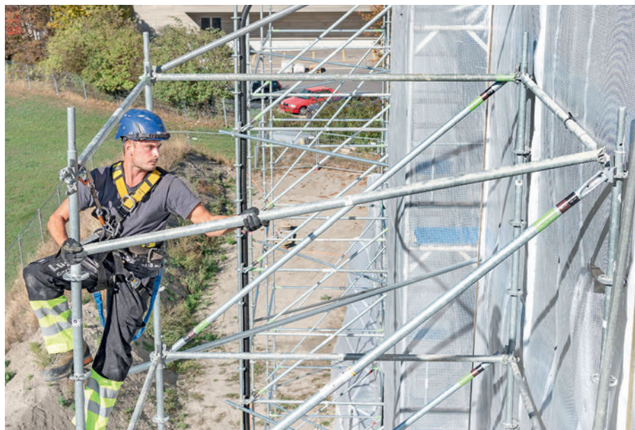
La stabilité de l'échafaudage principal est renforcée au moyen d'une tour. Ainsi, la structure ne craindra pas les rafales de vent.
